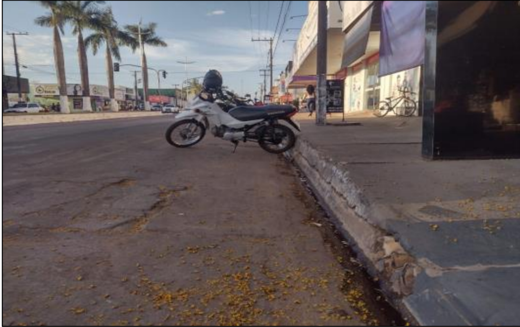
Figura 5 – Meio fio alto, com acessibilidade ineficiente na avenida Rio Arinos
