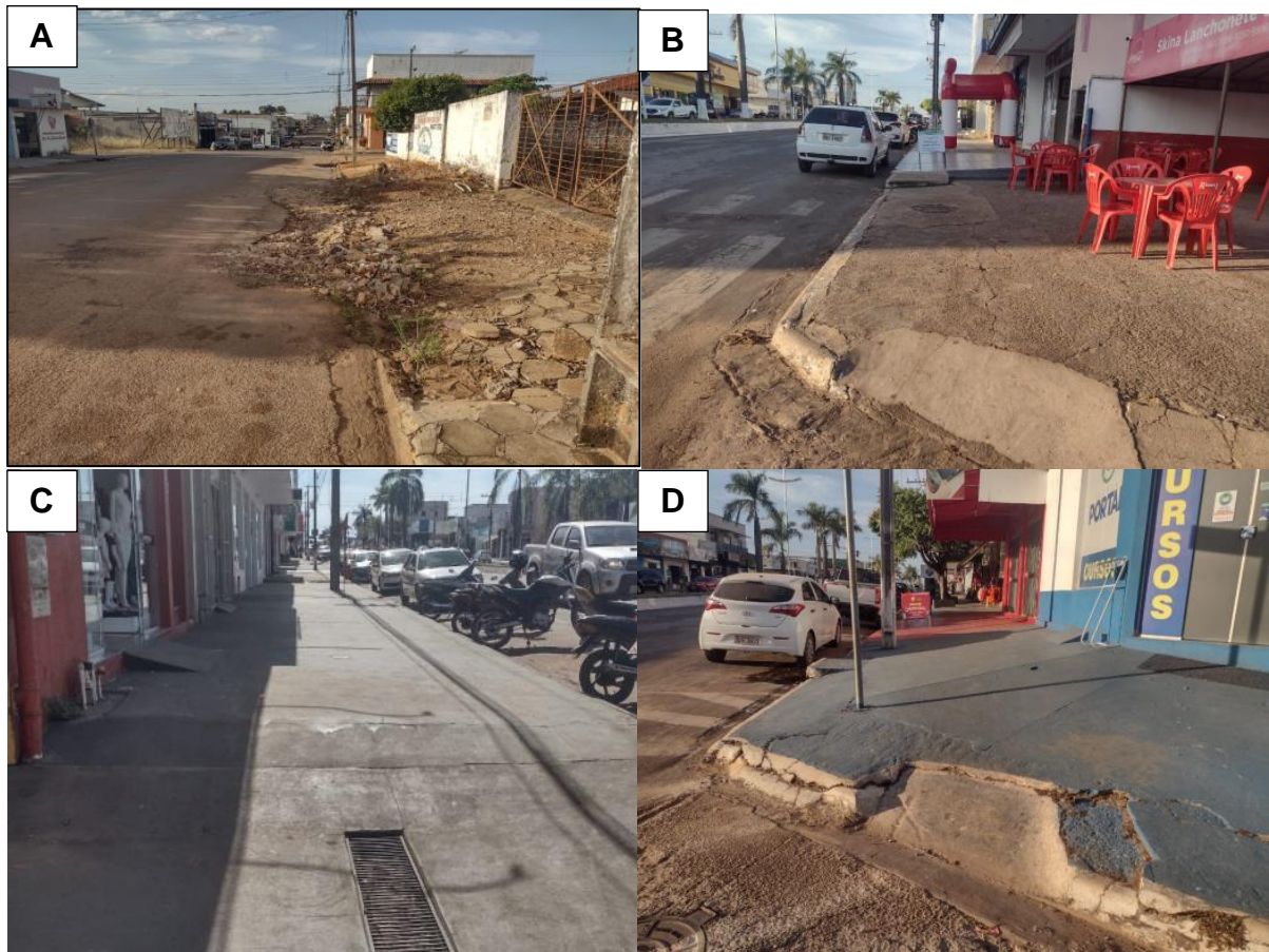
Figura 2 – Mosaico de imagens mostrando a situação das calçadas na malha urbana em Juara.
