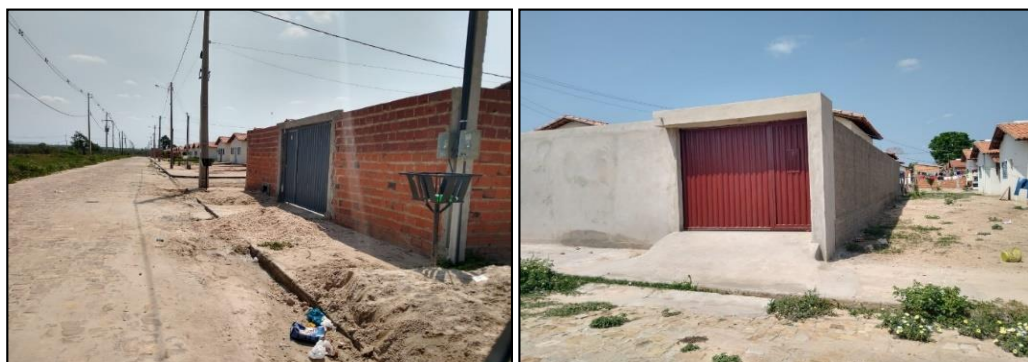
Figura 7 - Modificações nas moradias do Conjunto Habitacional Prefeito César Leal
